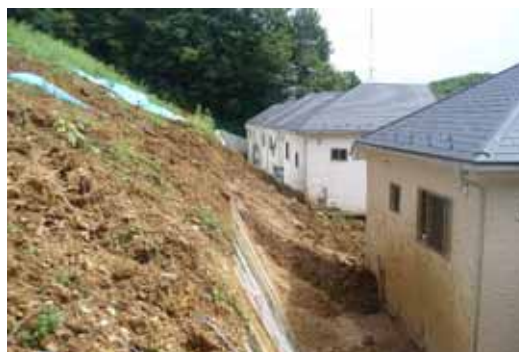
崩落した川町の斜面
