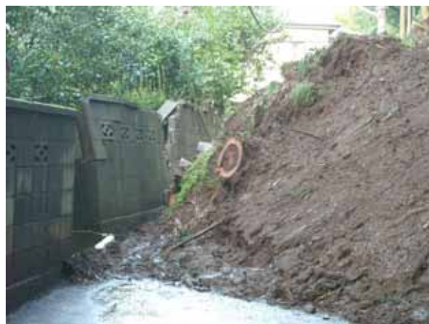
犬目町の土砂崩れ
