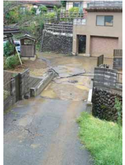
初沢町の道路被害
