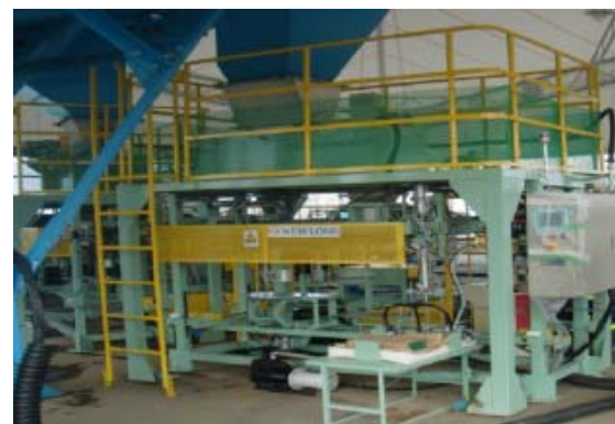
出典：石巻ブロック災害廃棄物処理業務現場だより
