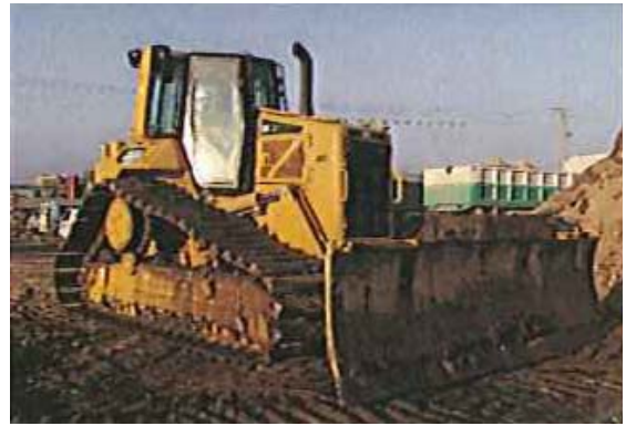
出典：石巻ブロック災害廃棄物処理業務現場だより
