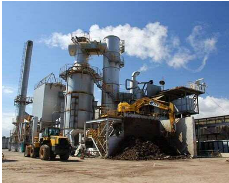
仮設焼却炉（宮城県仙台市）
