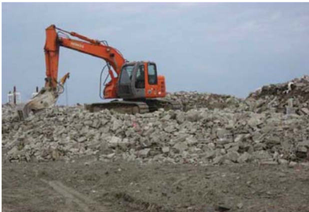
【写真1 コンクリートがら】
