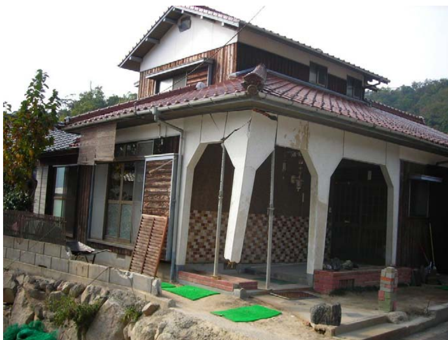
写真 5.1 奈美地区松ヶ谷川中流付近の半壊の住宅
