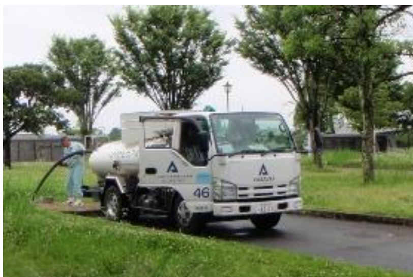
写真 2-3-1 東部浄化センター内の既存マンホールへの直接投入状況
