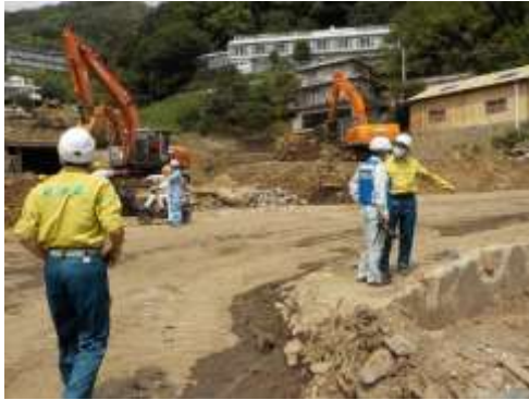
現地確認の様子 (令和3年8月31日) 写真撮影：館山市 写真出典：環境省「近年の自然災害における災害廃棄物対策について」令和3年12月
