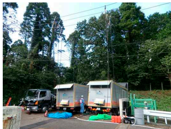
電源車2台・タンクローリーによる給油
