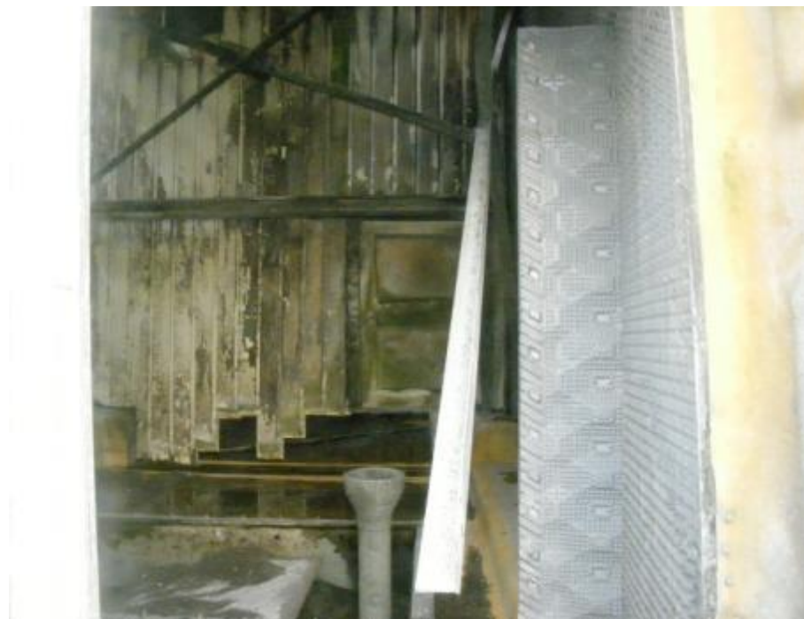
ブレース破損
