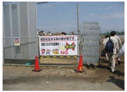
不法投棄禁止看板の設置
