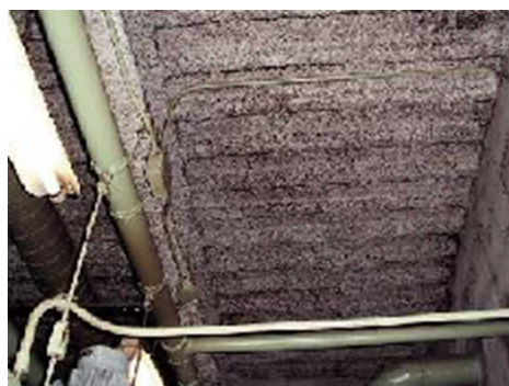
石綿含有吹付けロックウール
