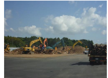
写真出典：環境省 災害廃棄物対策フォトチャンネル 平成 28 年熊本地震（2016 年 10 月 熊本県 二次仮置場）
