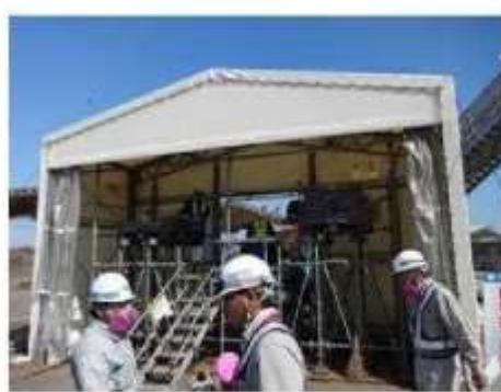
仮設焼却炉への投入設備 袋詰めすることにより、臭気はかなり押さえられている
