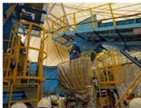
袋詰め供給コンベア
