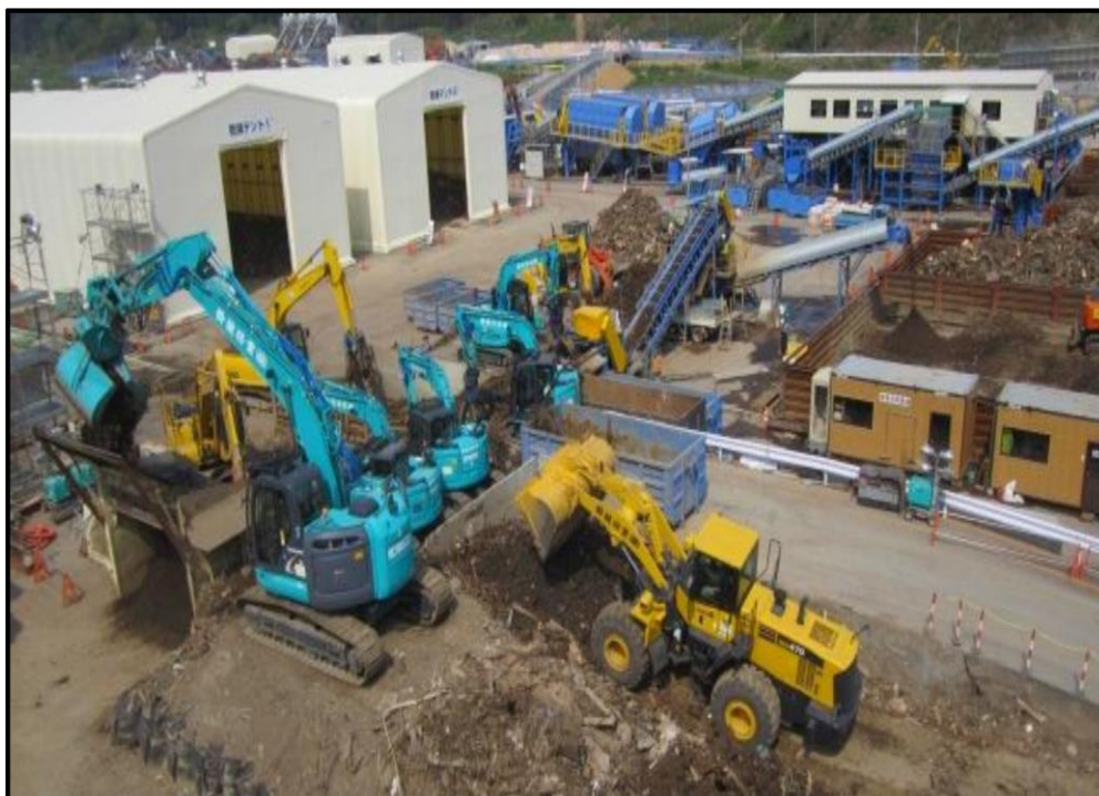
図 2.6-11 受入れ施設～乾燥用の大型テント
