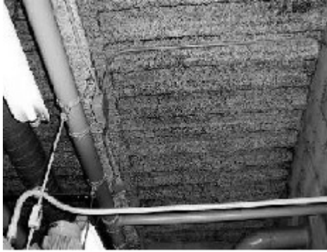
石綿含有吹付けロックウール
