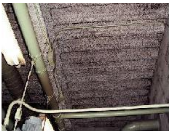
石綿含有吹付けロックウール
