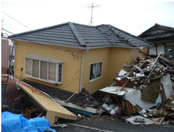
平成28年熊本地震被害状況
