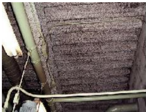
石綿含有吹付けロックウール
