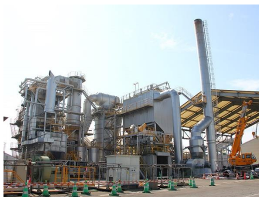
仮設焼却炉の状況
